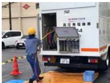
第八管区との電源供給訓練
